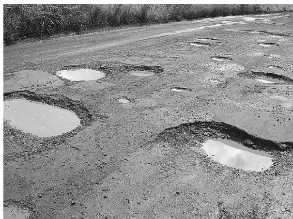
Trecho da SP-48: condição precária
